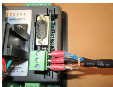
Extremo del cable del SCO 10 principal
