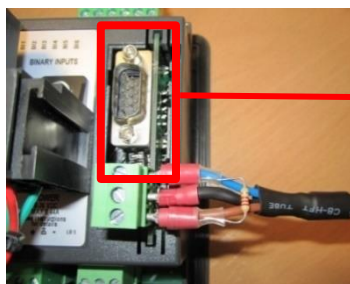
Extremo del cable del SCO 10 principal
