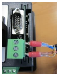
Extremo del cable del SCO10 remoto 1
