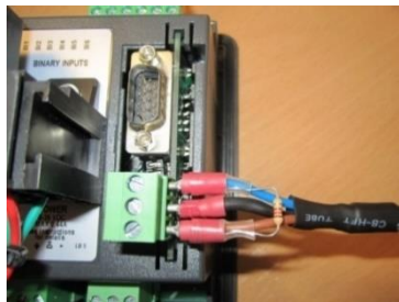
Extremo del cable del SCO 10 principal
