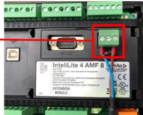
Extrémité du câble du SCO11 distant
