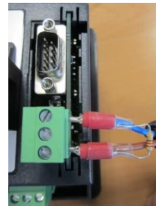
Extrémité du câble du SCO10 distant
