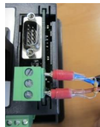
Extrémité du câble du SCO10 distant 1
