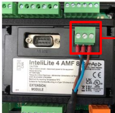
Câble du SCO 11 principal
