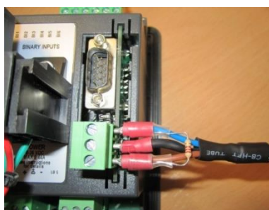
Extrémité du câble du SCO 10 principal
