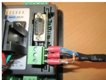
Extrémité du câble du SCO 10 principal
